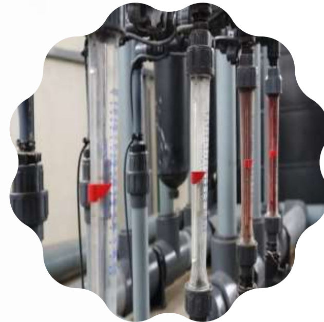
Optimización del agua, fertirriego automático
